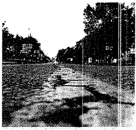
Pavimento agrietado en Madrid por las altas temperaturas. LGN
