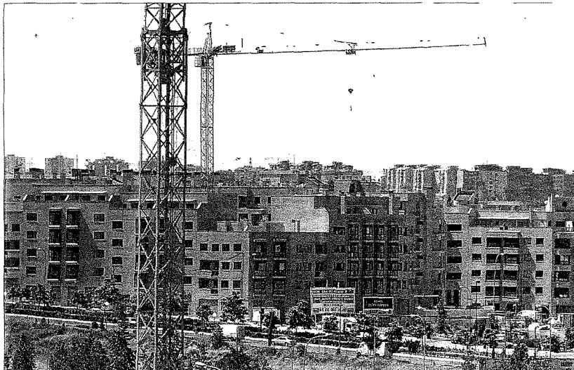
Construcción de pisos de obra nueva en un barrio de las afueras de Madrid.
